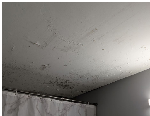
Salle de bain impactée par l'humidité, résidence Les Joncaux (Office 64) à Hendaye.
