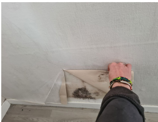
Le papier peint d'un logement, résidence Arretxea (COL) à Ustaritz, touché par l'humidité.
