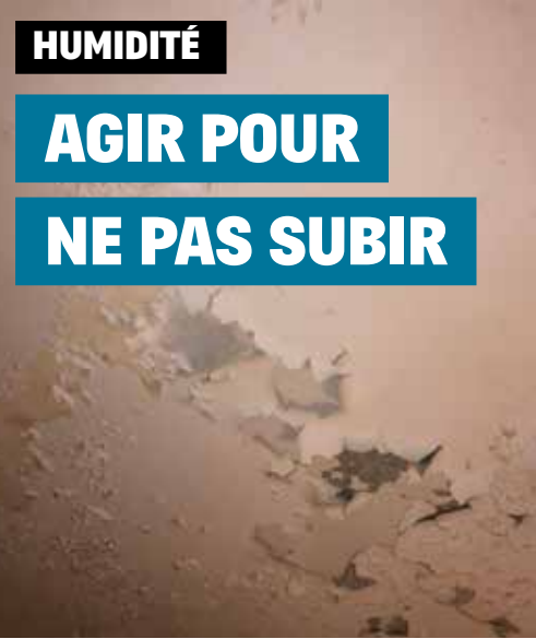
Traces d’humidité sur les murs d’une résidence HLM du quartier Urdazuri à Saint-Jean-de-Luz.
