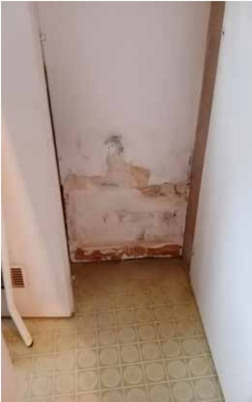
Les signes d’humidité dans la cuisine d’Anne-Marie, avant les travaux.
